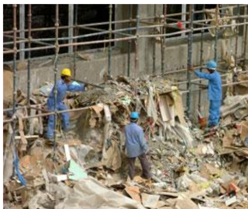
شکل ۱۳- عملیات عمرانی و مخاطرات آن
